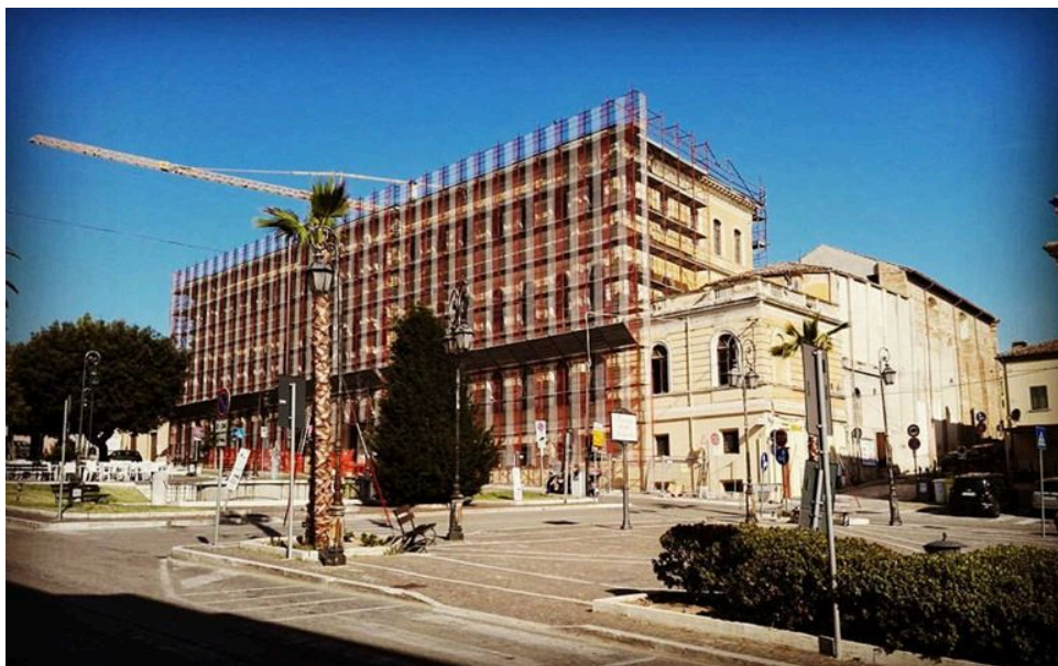
Scuola Edmondo De Amicis di Giulianova – Foto Walter De Berardinis In ristrutturazione
