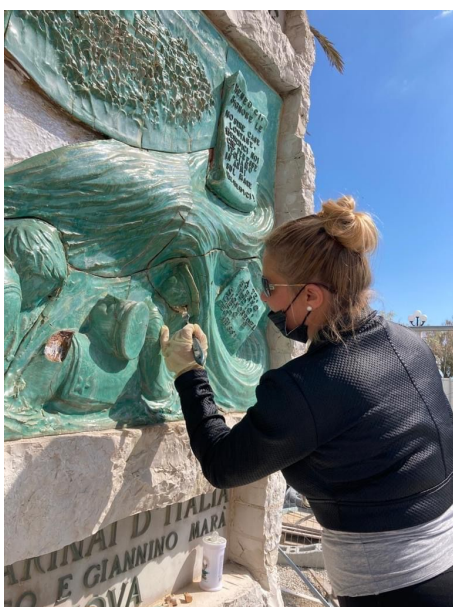
gli artisti gli artisti Loreto Cicoria e Donatella Massi al lavoro sul monumento
