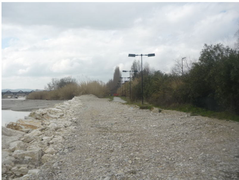
tratto ciclabile Tordino erosa dall'alluvione. FOTO ARCHIVIO
