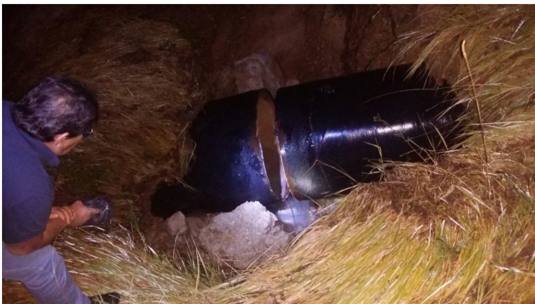
Rottura adduttrice Isola Ruzzo
